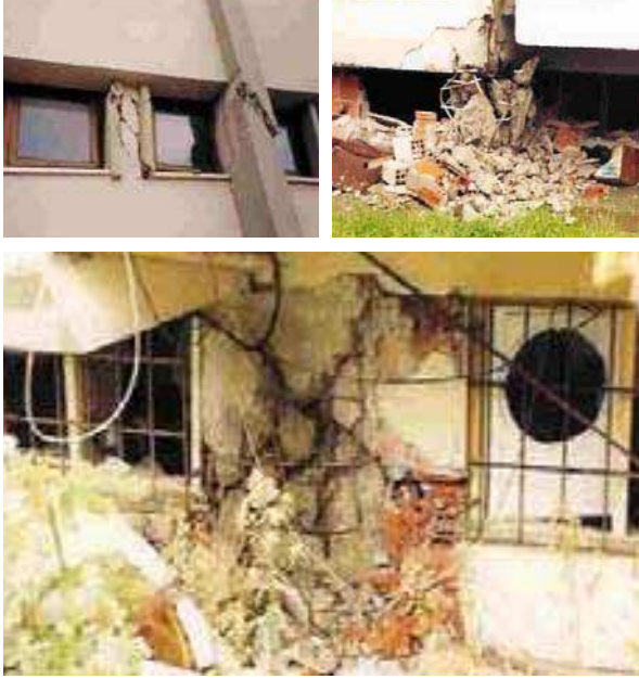
Şekil 3. Kısa kolon hasarları
