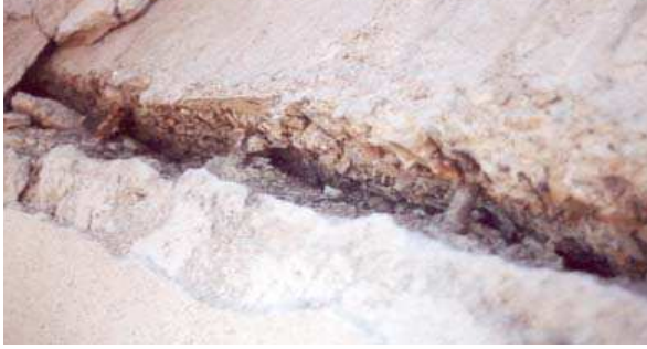
Tahta parçası ve talaşları temizlenmemesi nedeniyle katlar arası süreksizlik, soğuk derz oluşmuş beton
