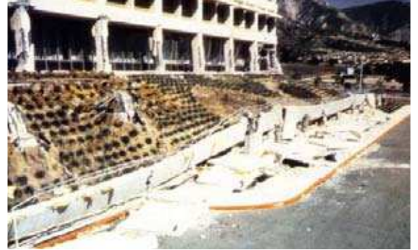
Çiçeklik Nedeni İle Oluşan Ağır Hasar 1971 San Fernando Depremi
