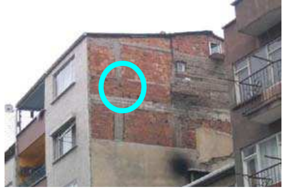
Şekil 1. İstanbul'da mevcut bir binada taşıyıcı kolonda süreksizlik
