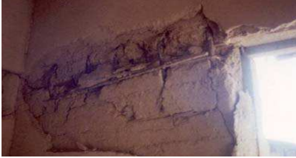
Dayanımı çok düşük kalitesiz beton
