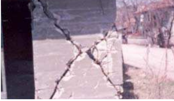
Kenarlarında kolon donatısı teşkil edilmemiş perde hasarı
