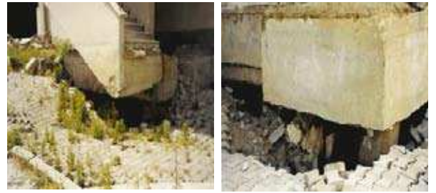
Şekil 9. Kalitesiz beton nedeni ile kazıklı temel başlığında oluşan hasar
