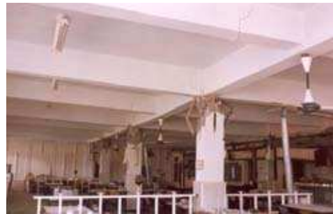
Kolonların Kirişlerden daha zayıf olması nedeniyle oluşan hasarlar
