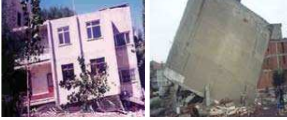
Şekil 2. Yumuşak kat hasarları
