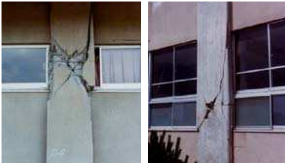
Depremde Kısa Kolon davranışı sonucu kesme kırılması
