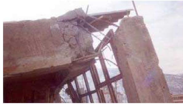
Kancası 135 ° kıvrılmış etriye Foto-Projesine göre 1/3 daha az ve uygun yerleştirilmemiş donatı, gönye kırılmamış adeta logo gibi duruyor. (Afyon-Çay Sanayi sitesi-2002)
