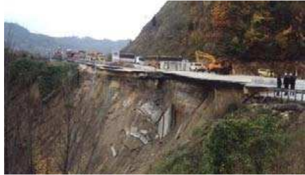
Şekil 2. Yerel zemin koşulları nedeniyle meydana gelen deprem kaynaklı hasarlara bazı örnekler
