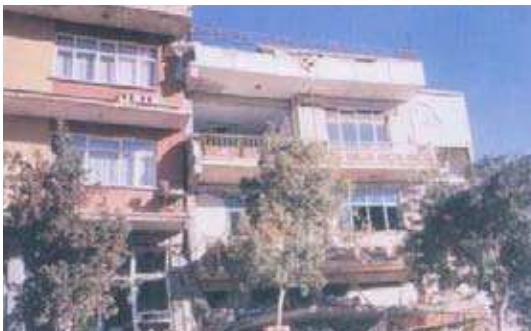
Betonarme Bina Çarpışması (1995-Dinar)
