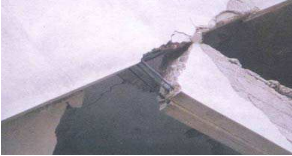
Beton dayanımı çok düşük, üstelik nervürlü donatı kullanılması sonucu donatının betondan kolaylıkla sıyrılması
