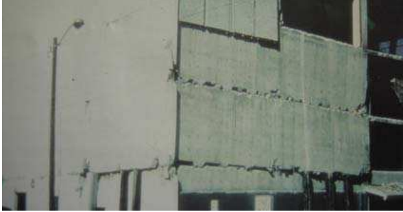
J.C. Penney Binasında Betonarme Perde Üzerine Kaplama-1964 Alaska Depremi
