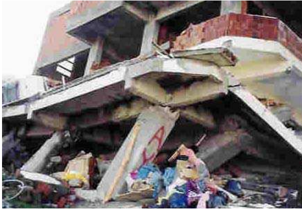
Şekil 30. Daha önce güçlendirilmesine rağmen Kasım 1999 Düzce depreminde ağır hasar gören bina
